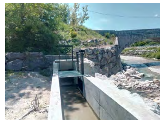
Prise d'eau du canal de la Bâtie Montsaléon modernisée et régulée
