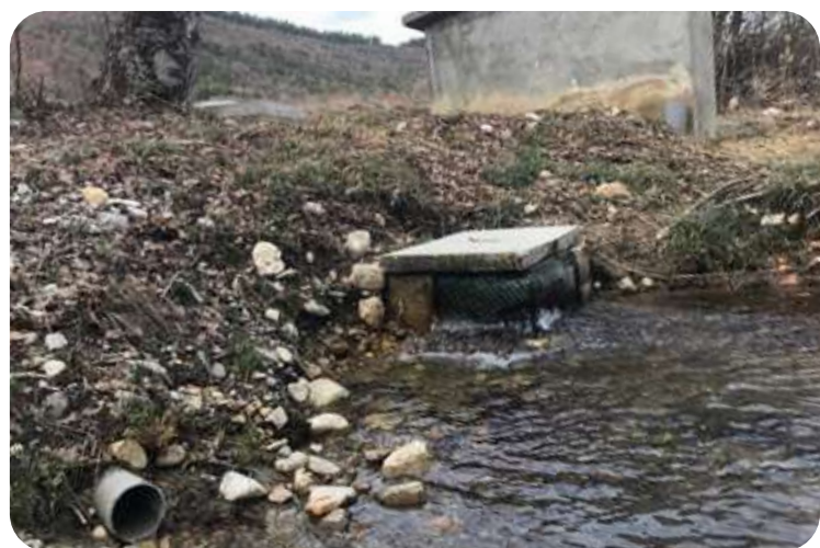
Figure 12 : Prise d'eau de l'adoux de Beaumette, 09/03/2026 (rejet : en bas à gauche; trop plein : au centre; station de pompage (en haut à droite))
