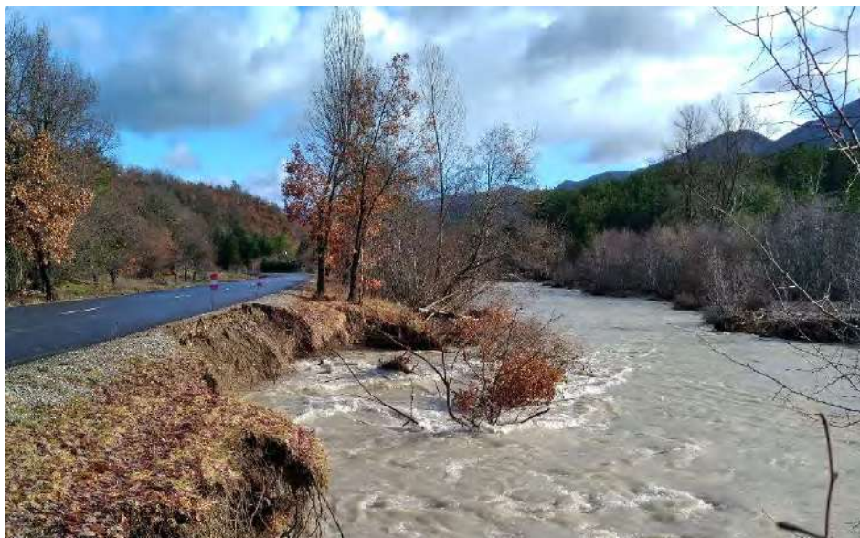
Figure 32 : Sapement de berge à Salérans suite à la crue de la Méouge du 20/12/2019
