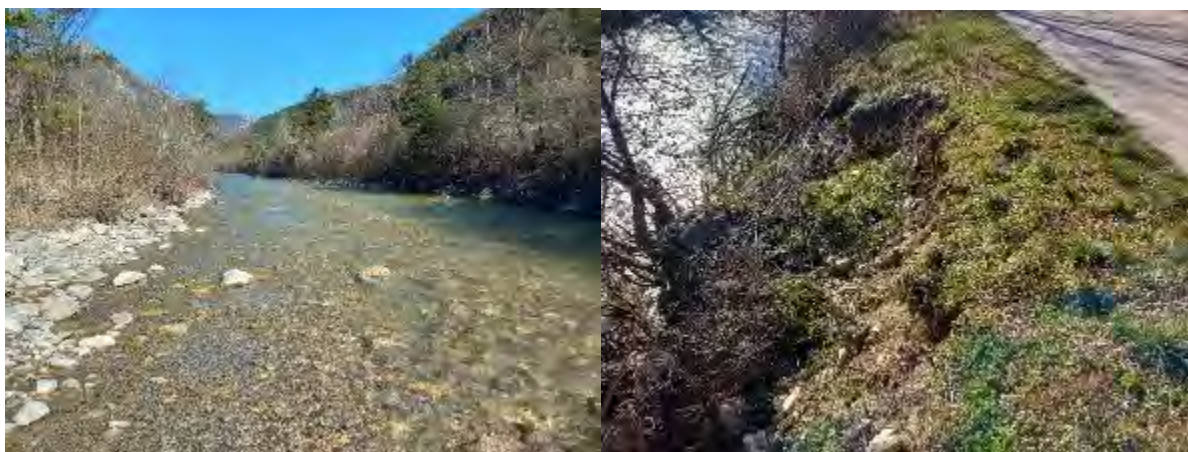
Figure 6 : Morphologie du cours d'eau à l'entrée dans la plaine des Levas et érosion de la digue en rive droite (AMETEN, 2023)
