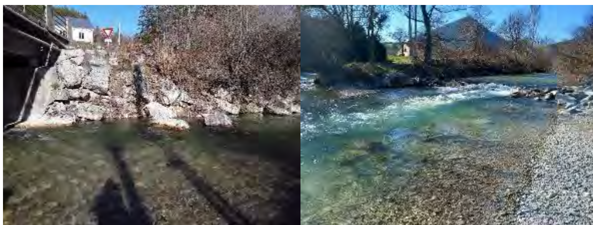
Figure 7 : Vues successives de l'encoche d'érosion en aval rive gauche du pont St-André puis du seuil (AMETEN, 2023)
