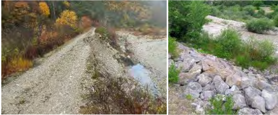
Figure 4 : Erosion de la digue suite à la crue de 2014 (SMIGIBA, 2014) et enrochement de protection mis en œuvre au même endroit (AMETEN, 2022)
